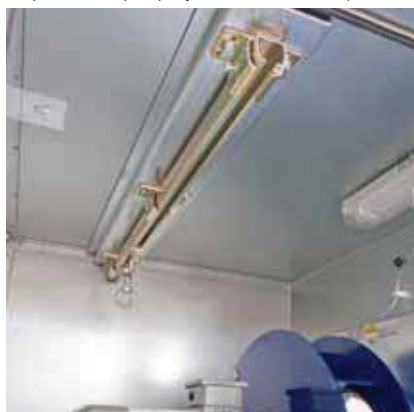
Выдвижная шина для демонтажа вентилятора
